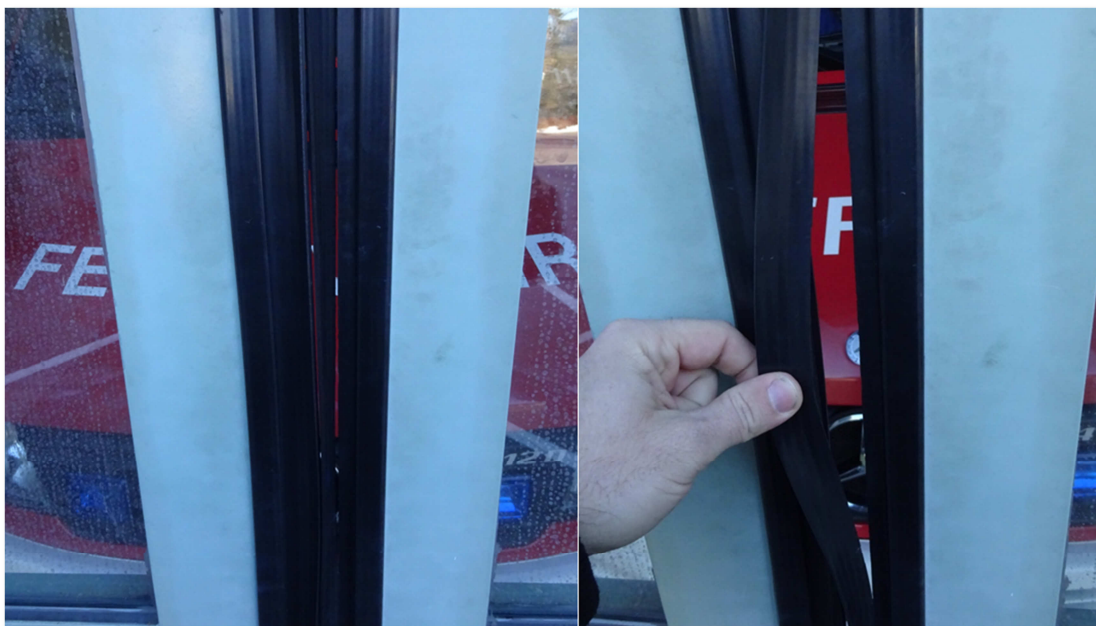
Abbildung 28: Dichtungen der FFW-Tore (FFW-Gebäude)
